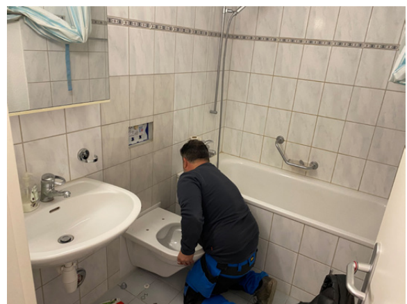
Die Defekte hatten Auswirkungen bis in den dritten Stock: Ersatz eines beschädigten WCs.
