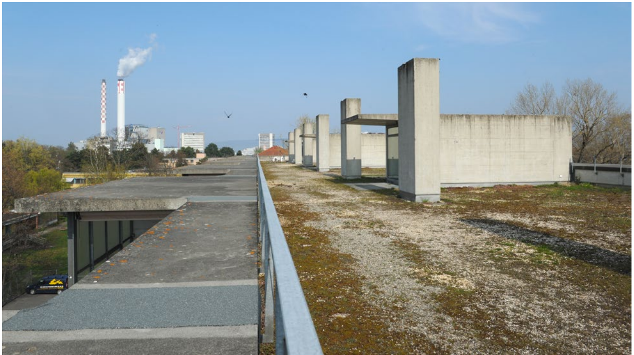
Gut sichtbar: Die Fugen links wurden neu gemacht und die Drainagen saniert, vgl. Umschlag Rückseite
